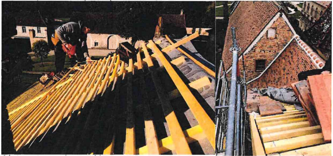
Travaux de pose de sous-toiture et jonction sur l'aile Seguin - © I. Blondin, architecte du patrimoine
