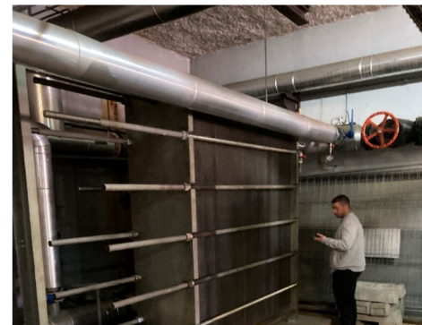
Echangeur de chaleur de l'installation de Châteauroux © BRGM – Mikael Philippe
