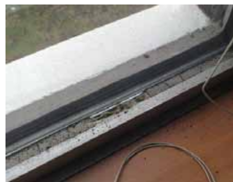
Joints de fenêtres
