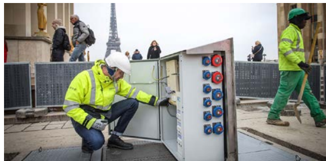
Borne électrique rétractable pérenne ©Enedis
