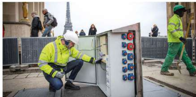
Borne électrique rétractable pérenne ©Enedis
