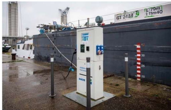
Exemple d'une borne électrique alimentant un bateau ©Actu FR
