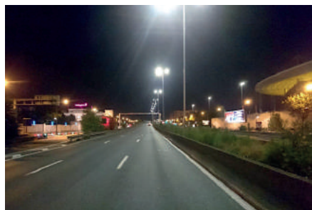
L'éclairage rénové de l'autoroute A1 avec des LED.
