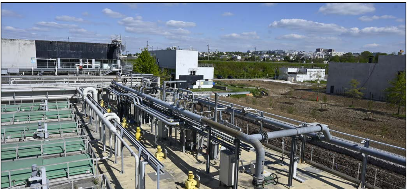
SIAAP : Station du SIAAP « Marne Propre » à Noisy-le-Grand ©SRCI
