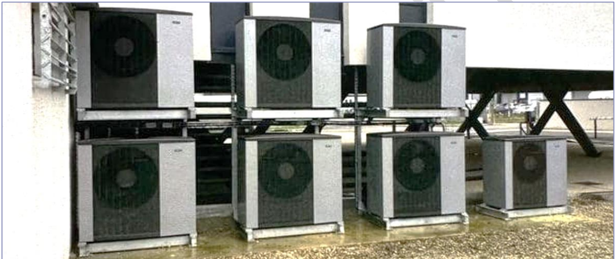
Illustration de pompes à chaleur installées en cascade 15
