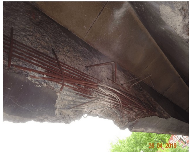
Figure 1 : Désordres suite au choc de 2019
