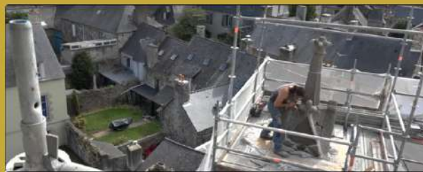
Restauration de la cathédrale de Dol de Bretagne dans le cadre du plan de relance
