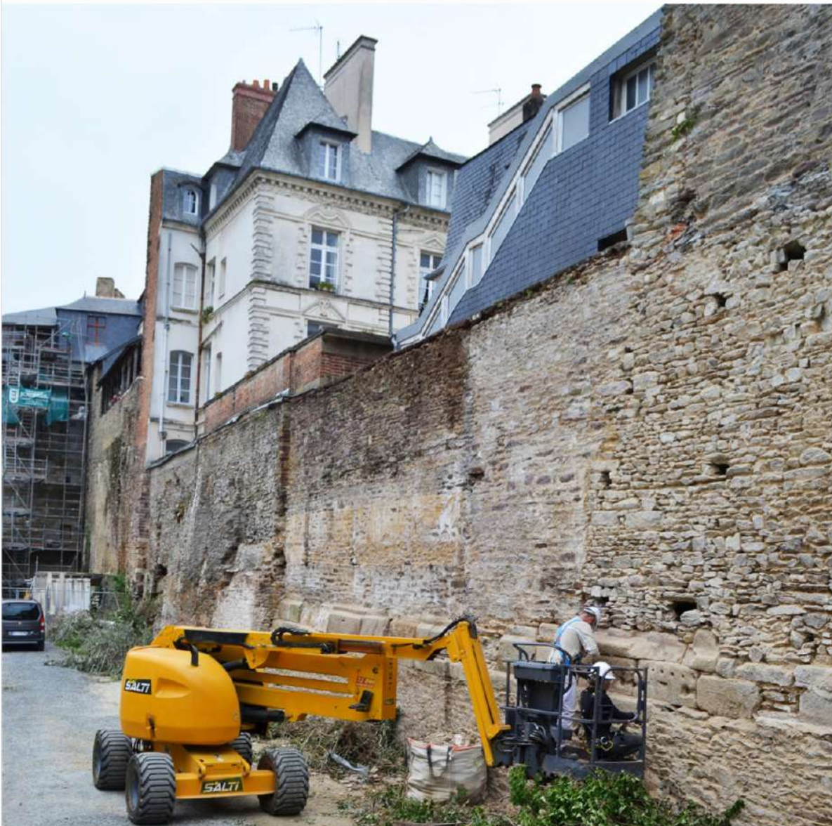
Fouilles et travaux sur le tronçon de rempart du parcours des portes Mordelaises, Rennes
