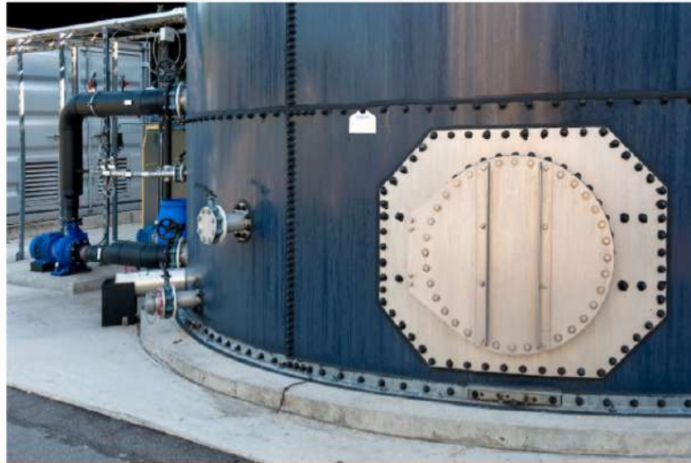
Usine de méthanisation
