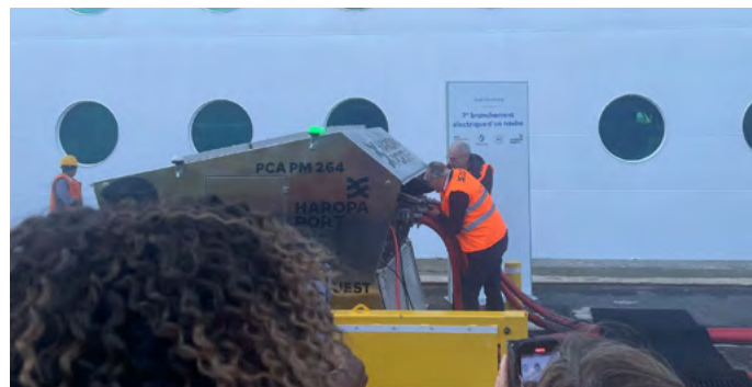
Électrification des quais croisières d'Haropa port au Havre (Seine-Maritime)
