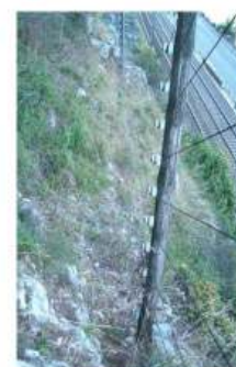
Systèmes de détection d'éboulement connectés à la signalisation pour arrêter les trains
