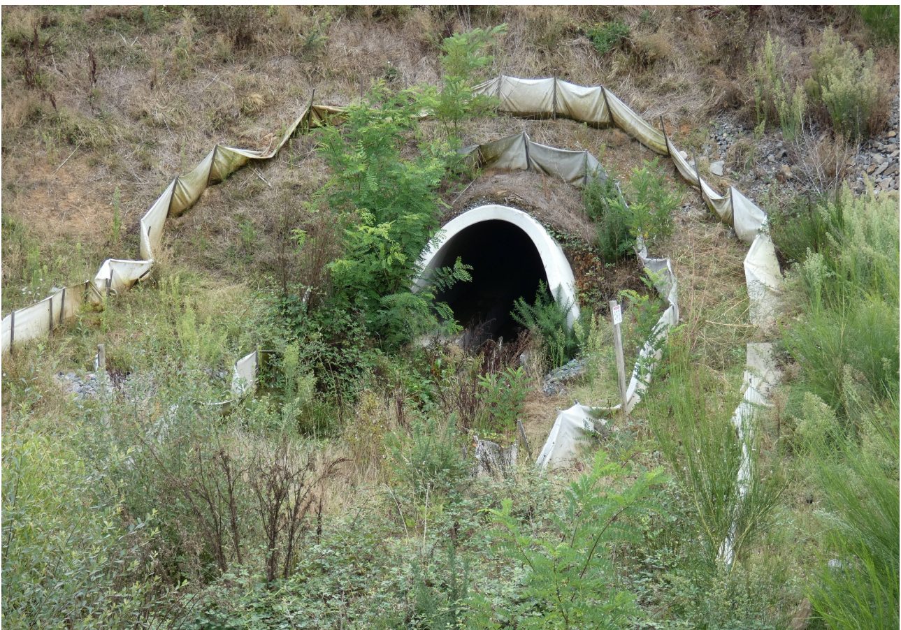
Ouvrage de traversée permettant le franchissement de la RN141 par la petite faune, notamment le sonneur à ventre jaune (espèce protégée)
