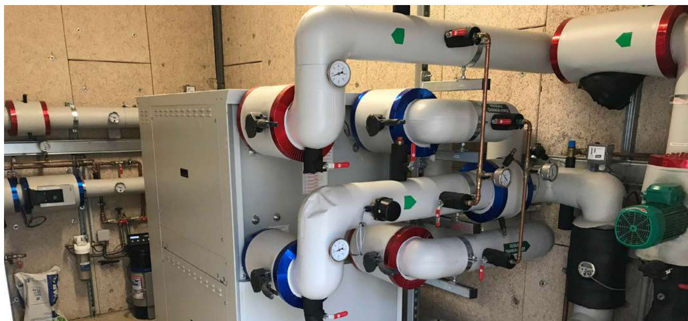
Photo : Chaufferie bois école Riaillé
